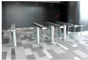
車いすの方も通門できる 入出門ゲート（群馬製作所・西本館）
