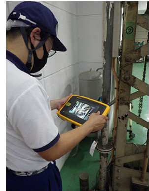
エアーリーク調査の様子
